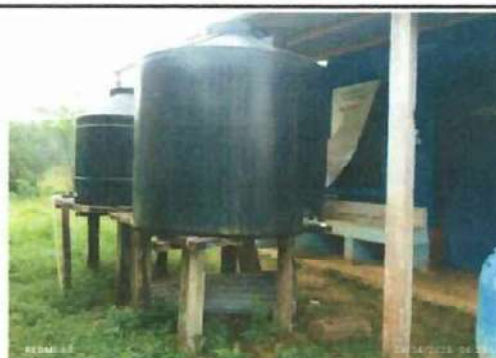
Foto 4: Se observa deterioro del lugar de los tinacos
