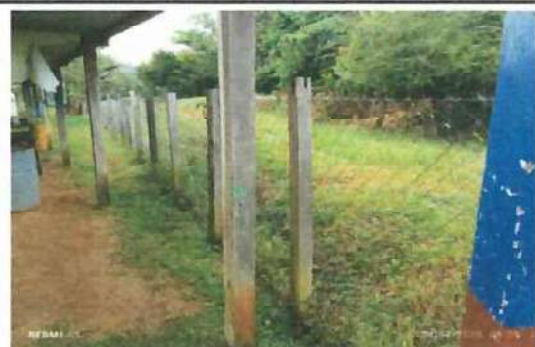
Foto 5: Se observa el mal estado de la malla perimetral,
