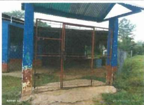
Foto 1: Se observa deterioro y oxidación del portón.
