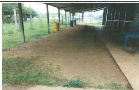
Foto 3: Se observa que no tiene piso el corredor y no hay un lugar adecuado para realizar actividades.
