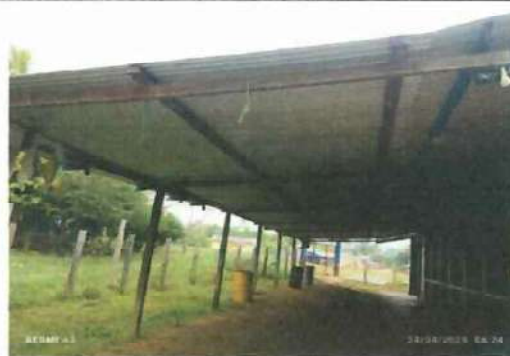
Foto 2: Se observa deterioro del techo del corredor, así también horcones, las vigas y costaneras.
